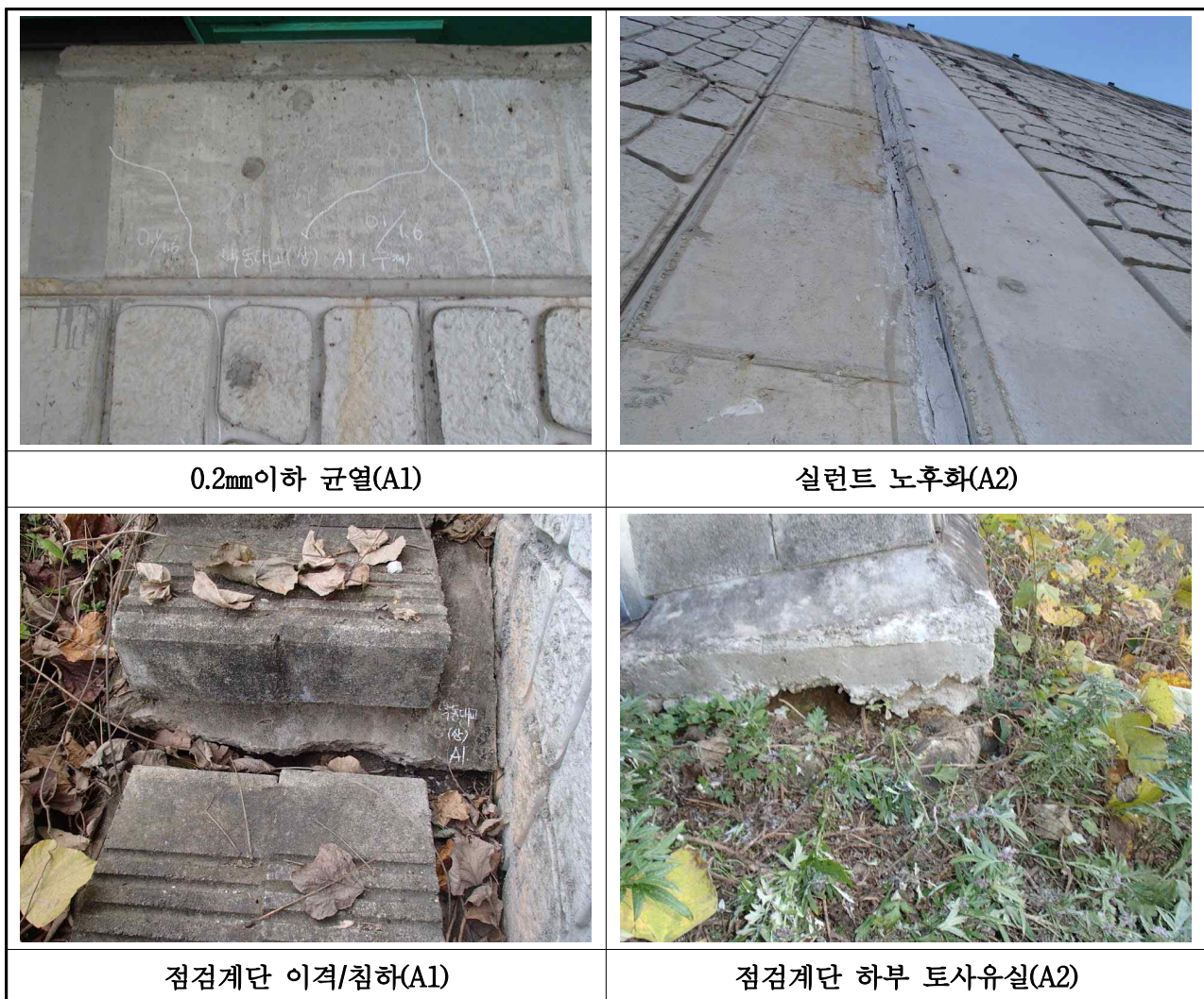
【사진 3.2.8】 교대 손상현황(대구)
