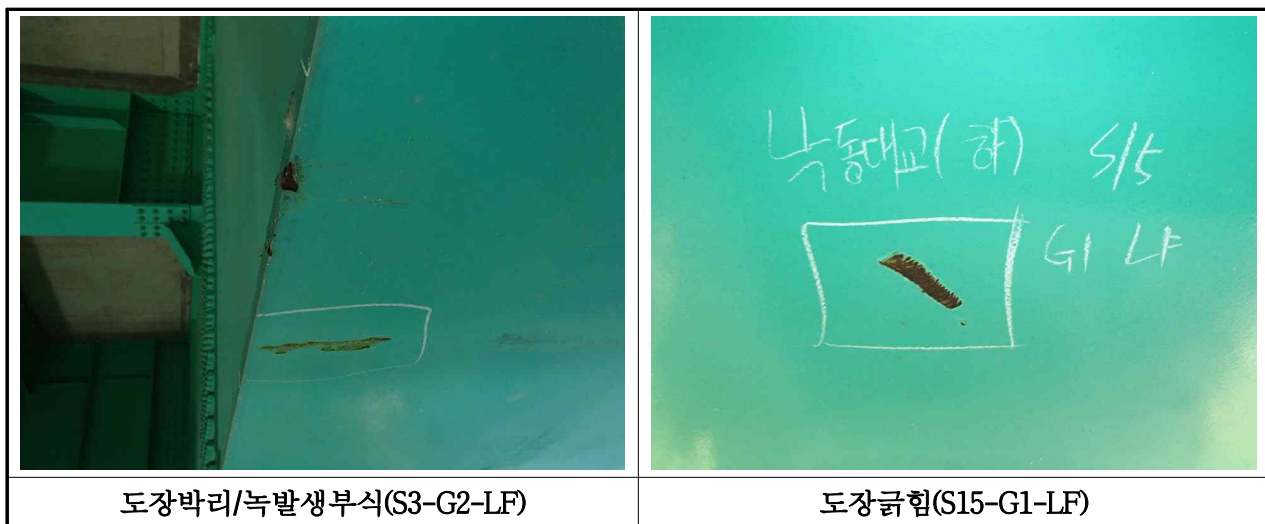
【사진 3.3.5】 강박스 거더 외부 손상현황(부산)
