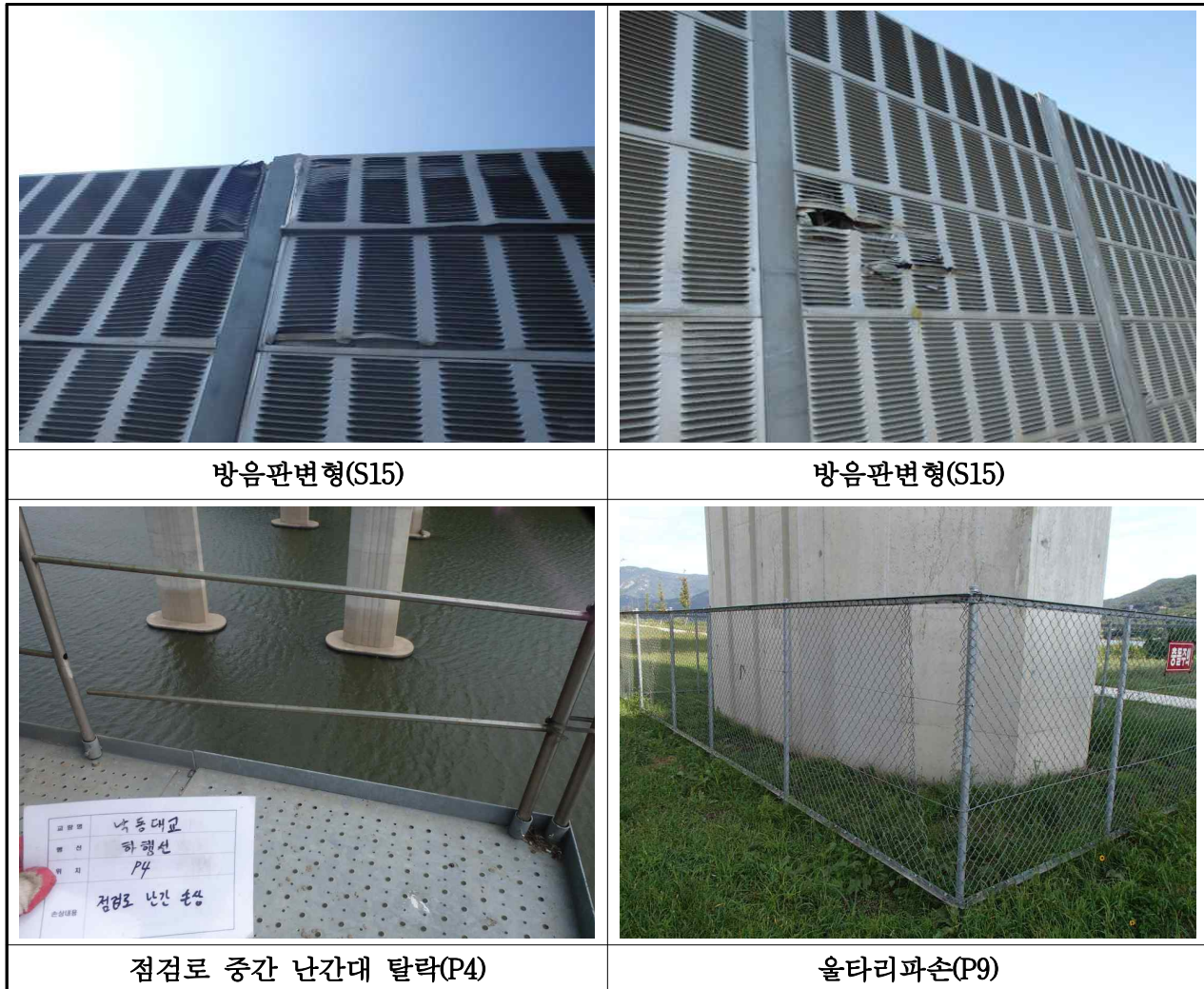
【사진 3.3.25】 기타 시설 손상현황(부산)
