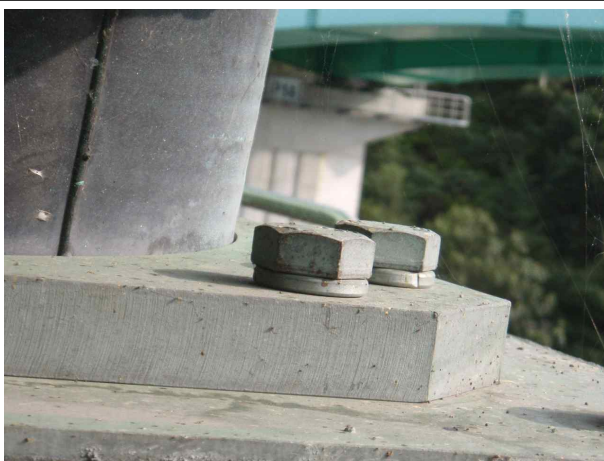
받침장치 볼트 녹발생(P2-Sh1)
