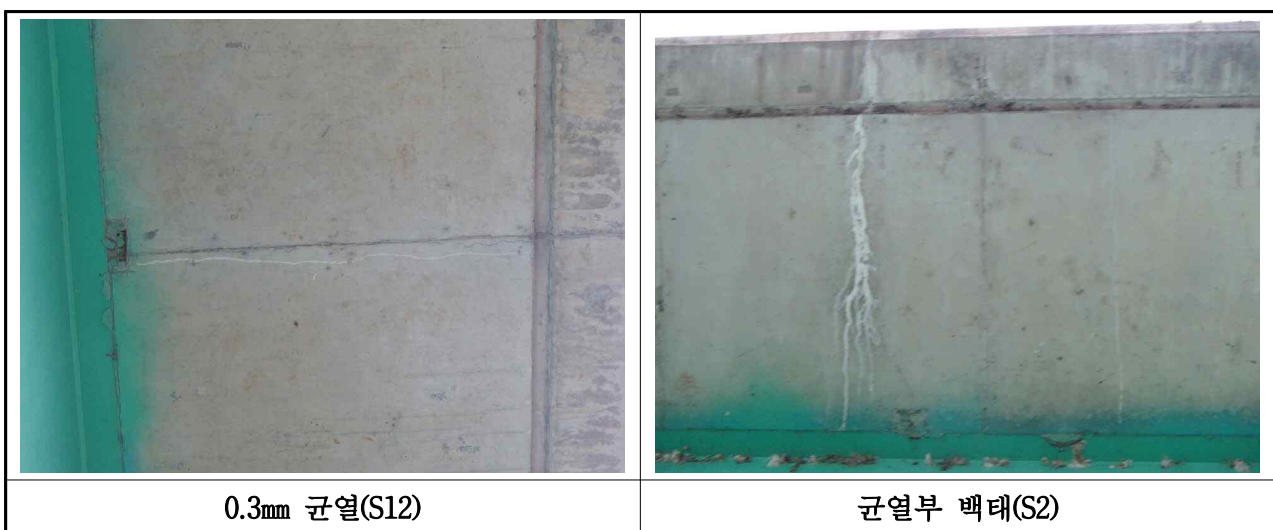
【사진 3.2.2】 바닥판 하면 손상현황(대구)
