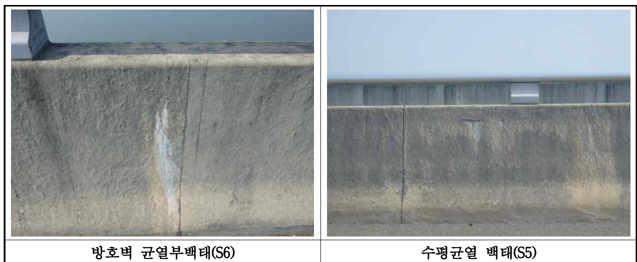
【사진 3.3.24】 방호벽 손상현황(부산)
