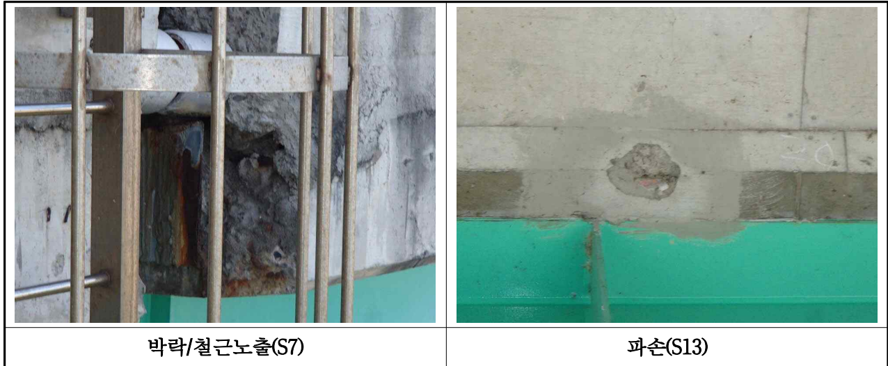
【사진 3.2.2】 바닥판 하면 손상현황(대구, 계속)
