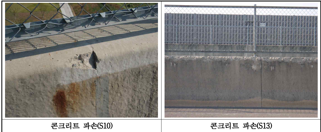
【사진 3.2.24】 방호벽 손상현황(대구, 계속)
