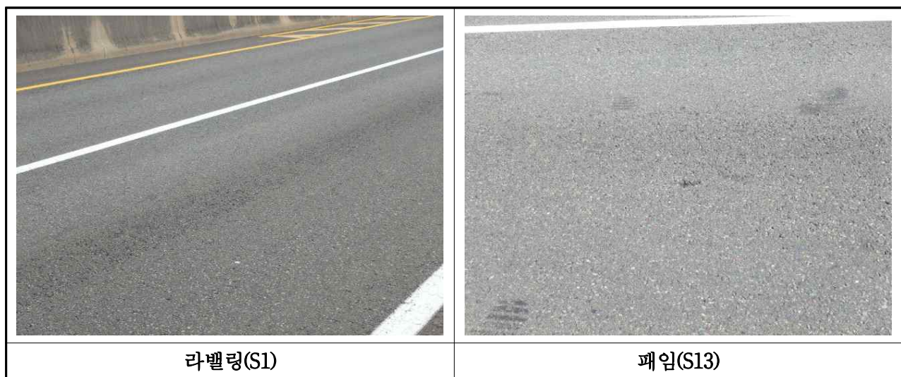
【사진 3.3.20】 교면포장 손상현황(부산)
