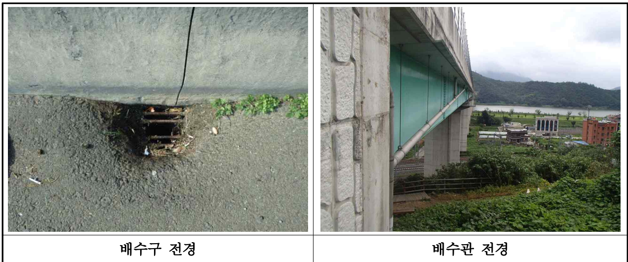
【사진 3.3.21】 배수구 및 배수관 전경(부산)
