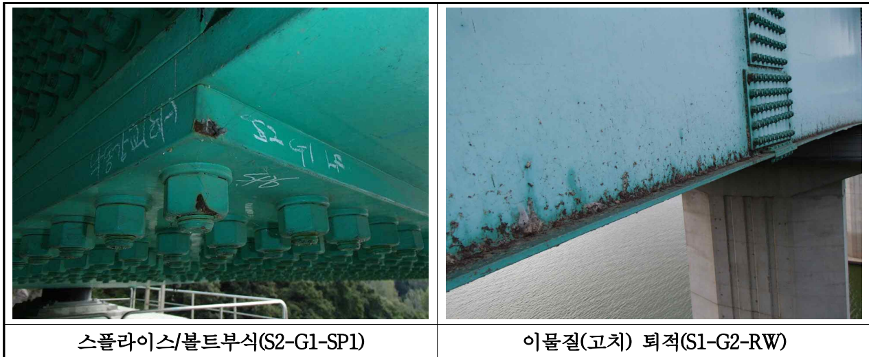
【사진 3.3.5】강박스 거더 외부 손상현황(부산, 계속)
